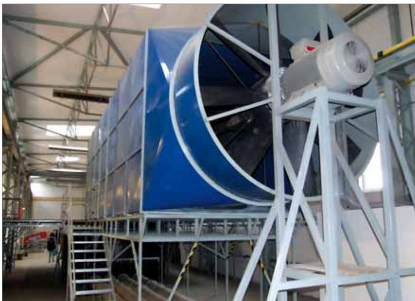
Ventilátor na simuláciu bočného vetra (priemer vrtule je 2,8 m; tunel musí mať inštalované špeciálne prvky na usmernenie prúdenia).
