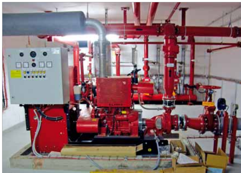
Naftový agregát pre stanicu stabilného hasiaceho zariadenia.
