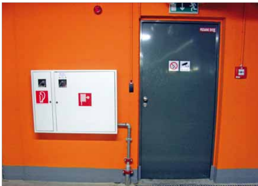
Hasiaci prístroj, hydrant, únikový východ protipožiarnymi dverami a tlačidlový hlásič EPS.
