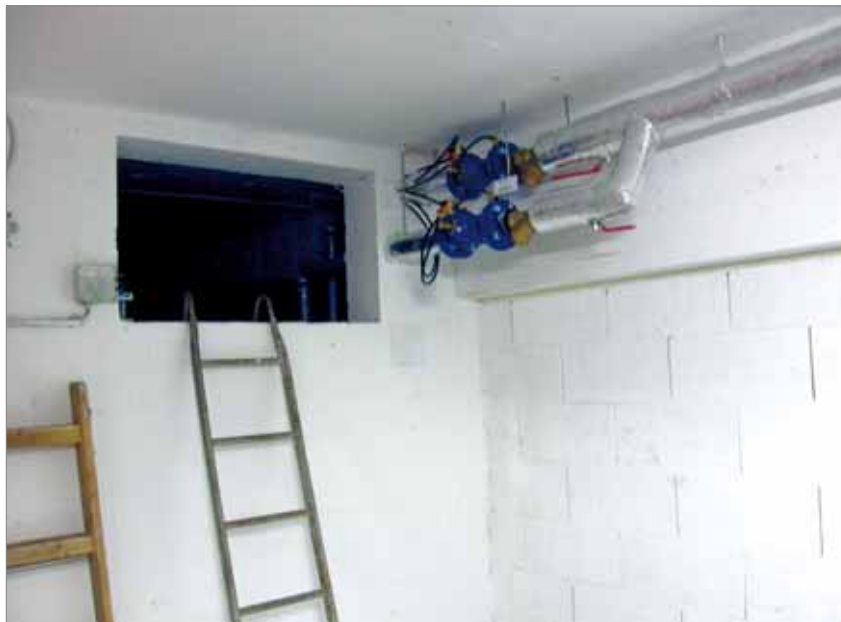
Požiarna nádrž – revízny otvor a potrubná sústava stabilného hasiaceho zariadenia.
